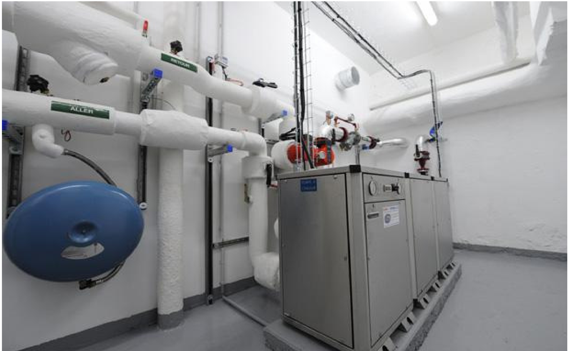
Die Wärmepumpe von Wattignies Schule
